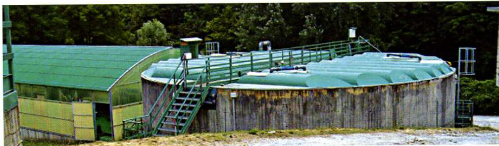
Depuratore realizzato da Se.Ver.Acque s.r.l. a Galliciano località Debbiali.
